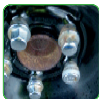
Rost på hjulmuttrar eller bultar.
